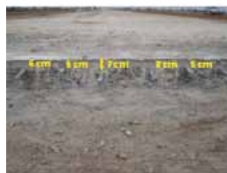
Figura 15: pasadores desplazados, losa demolida por fisuras transversales.
