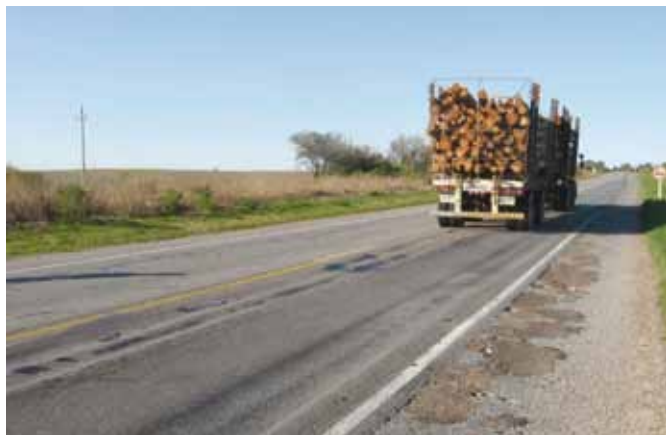
Fig. 2. Estado de la Ruta 24 antes de ser rehabilitada (fotografía del 17/09/2010).
