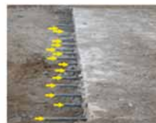
Figura 16: Vista lateral de los pasadores de la figura 15.
