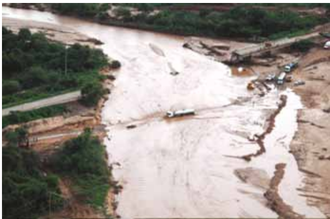
Nótese que sobre margen derecha el puente tiene dos vanos libres de caudal, sin daños, puesto que la creciente se recostó sobre la margen izquierda
