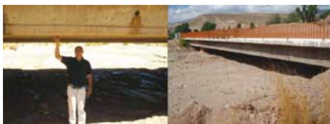
Disminución progresiva del tirante libre por sedimentación
