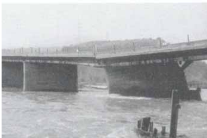
Puente sobre río Mapocho, falla del puente por erosión en la pila en su cara de aguas arriba
