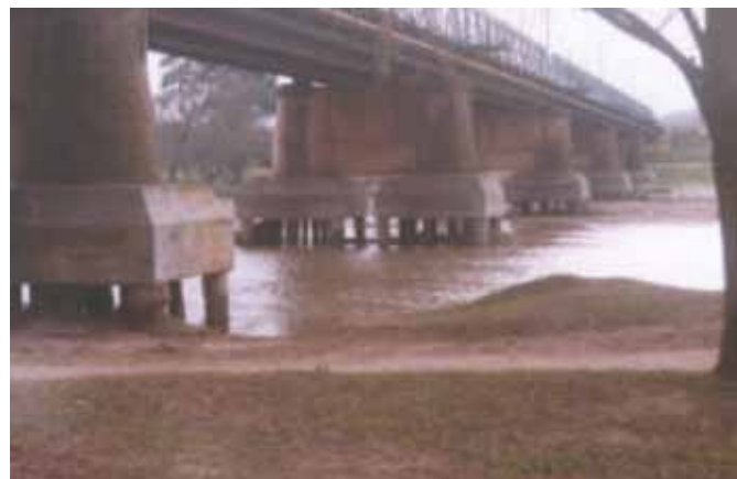
Descalce de pilas de puente carretero por descenso de cota del lecho – Río Cuarto – Córdoba (H.D.Farías)
