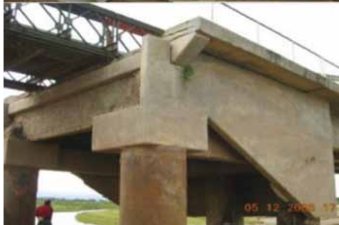
Erosión en estribo que lo ha dejado sin el Terraplén de aproximación
